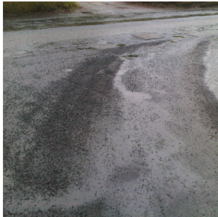
Vaurioitunut tie, joka antaa aihetta epäillä, että vauriot voivat olla seurausta huonosti sekoitetusta asfaltista.
