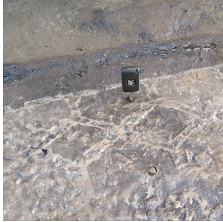
Asfaltin vaurioituminen ja pehmentyminen polttoaineiden vaikutuksesta.
