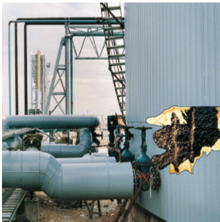
Tankisolering som blivit indränkt med bitumen skall bytas ut.
