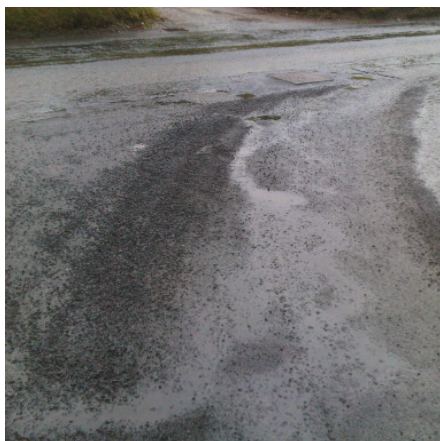
En skadad väg som tyder på att defekterna kan bero på dåligt blandad asfalt.
