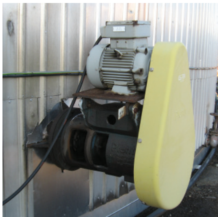
Eldriven omrörare sidmonterad på en förvaringstank för bitumen.
