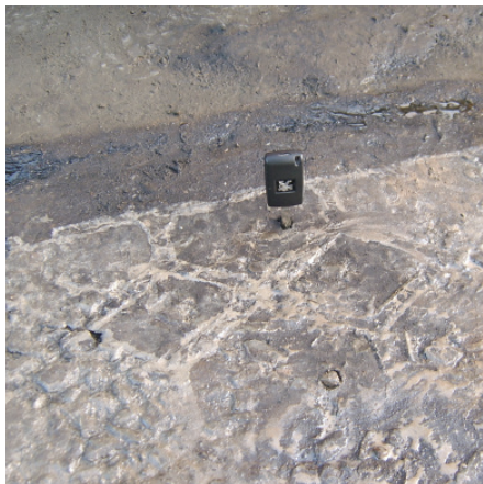
Försämring och uppmjukning av asfalt på grund av bränsleutsläpp.
